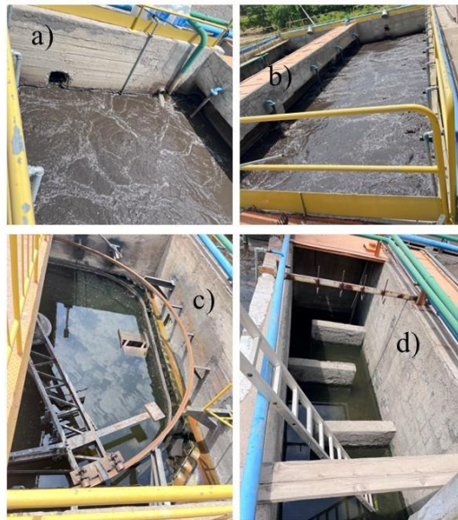
شکل ۱. تصویر تصفیه‌خانه پساب انسانی به شرح مراحل (a ورودی هوادهی، (b لجن فعال، (c چربی گیر، (d خروجی فیلتر شنی. Figure 1. Image of a human sewage treatment plant with description of the stages: a) aeration inlet, b) activated sludge, c) grease trap, d) sand filter outlet.
