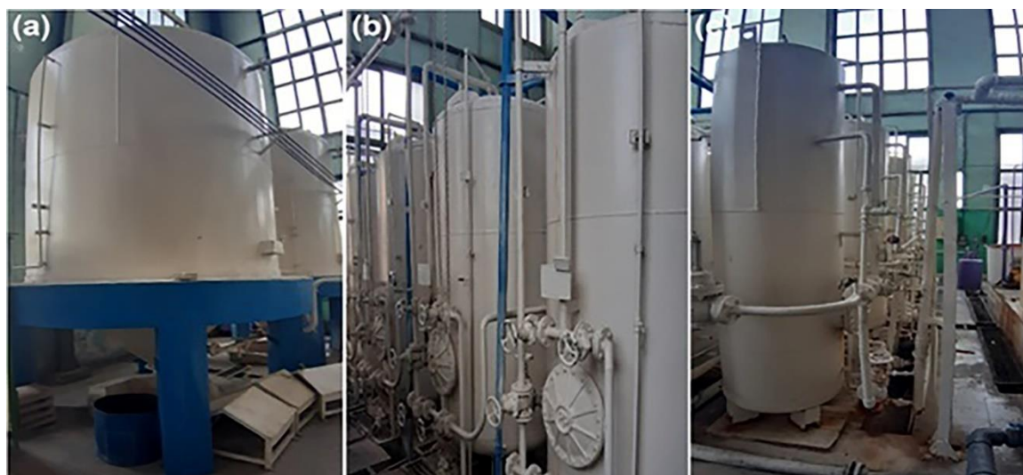
شکل ۳. تصاویر (a) دکانتور (b) صافی‌های شنی و (c) رزین‌های کاتیونی سدیمی در تصفیه‌خانه قدیمی نیروگاه طرشت.
