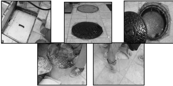
شکل ۲. درب‌های غیر استاندارد نصب‌شده در برخی از چربی‌گیرهای شهر مشهد.
