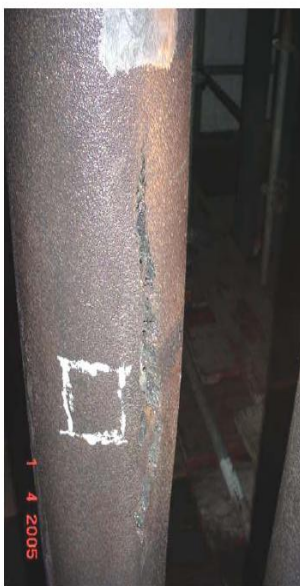
شکل ۳- یک لوله رایچر شده در اثر پدیده فوق دمایی
